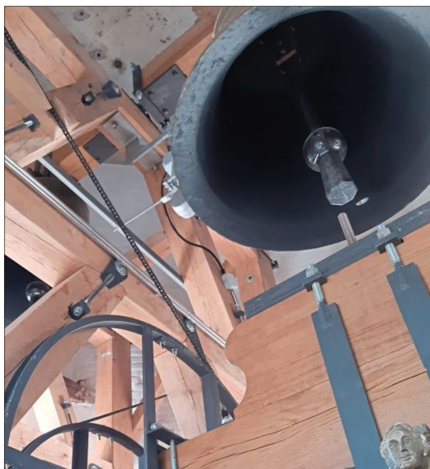
Einen stabilen Eindruck macht der neue Glockenstuhl. – Weit ins Land strahlt die neu hergerichtete Turmkuppel mit dem vergoldeten Kreuz. Foto: Peter Köppen
